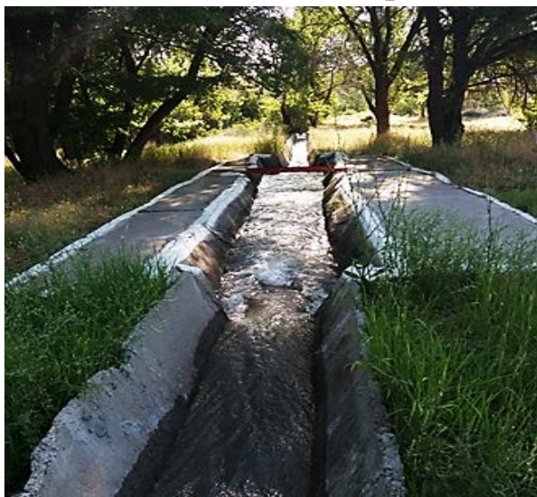
Рис. 1.6. Гидропост трапецеидального сечения на лотковом канале.
