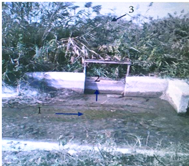
Рис. 1.3. Водовыпуск СХ-3 из канала КРВХ-1 Р-24 ЗБЧК. 1 – старший канал; 2 – щит; 3 – указано место установки гидропоста.
