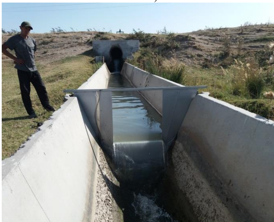
Рис. 2.27. Прямоугольный водослив на лотковом канале Подпитка-2 системы ЗБЧК. а, б – соответственно воды с нижнего и верхнего бьефов.
