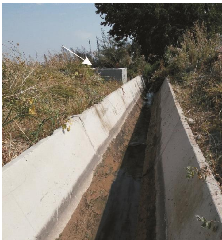
Рис. 2.11. Водомерное сооружение типа «Фиксированное русло» на канале «Правый Восток» ЮБЧК. Стрелкой указано место размещения успокоительного колодца.
