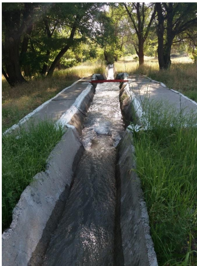
Рис. 2.6а. Гидропост на канале Белек-1 с.р.Ала-Арча (сечение трапецеидальное)
