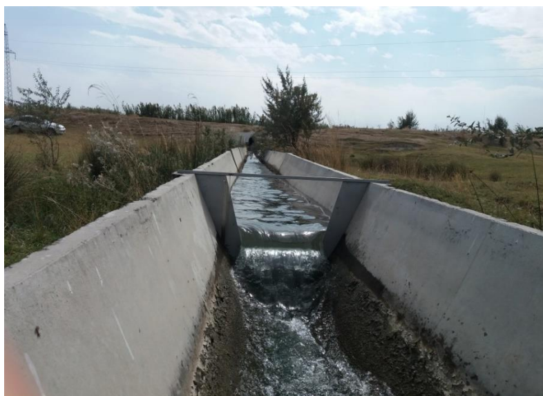
Рис. 2.18. Водослив Чиполетти на лотковом канале Подпитка 2 в работе, а, б – соответственно вид с верхнего и нижнего бьефов.
