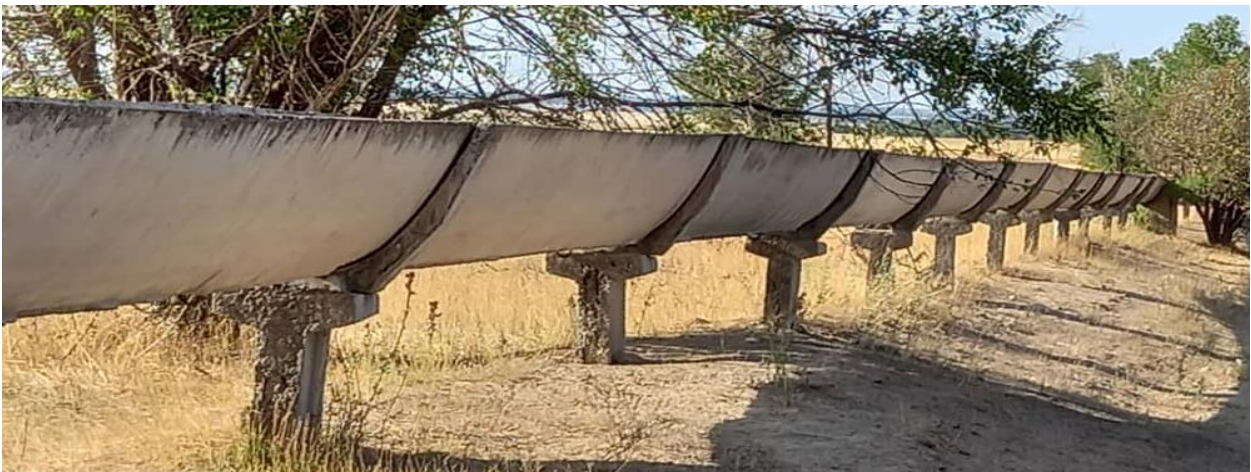
Рис. 7.1. Правый отвод лоткового канала Токбай. а, б – в начальной и средней частях.
