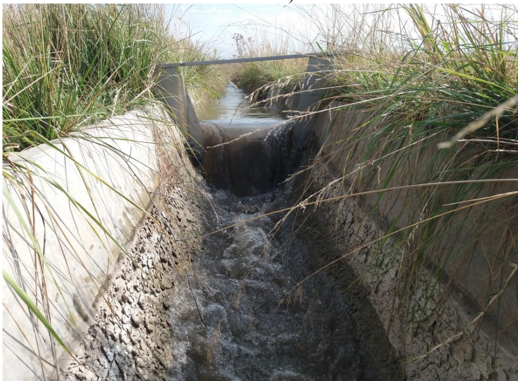
Рис. 2.21. Параболический водослив на лотковом канале Р-1-5 Новый в работе. а, б – соответственно вид с верхнего и нижнего бьефов.
