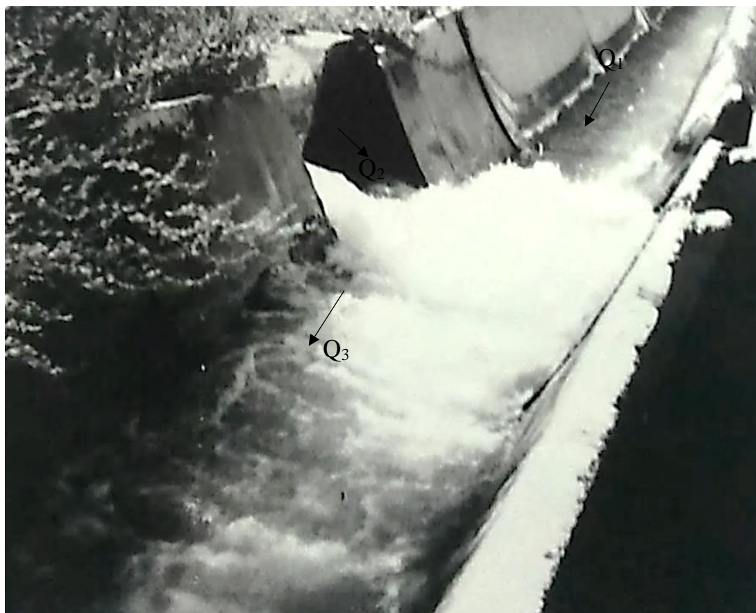
Рис. 5.1. Подпитывающее сооружение на лотковой сети системы р. Ала-Арча.
