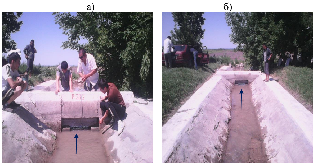
Рис. 9.32. Водомер типа «Прямоугольный насадок» на Р-20-3 ЗБЧК. а – идет строительство; б – водомер в работе.
