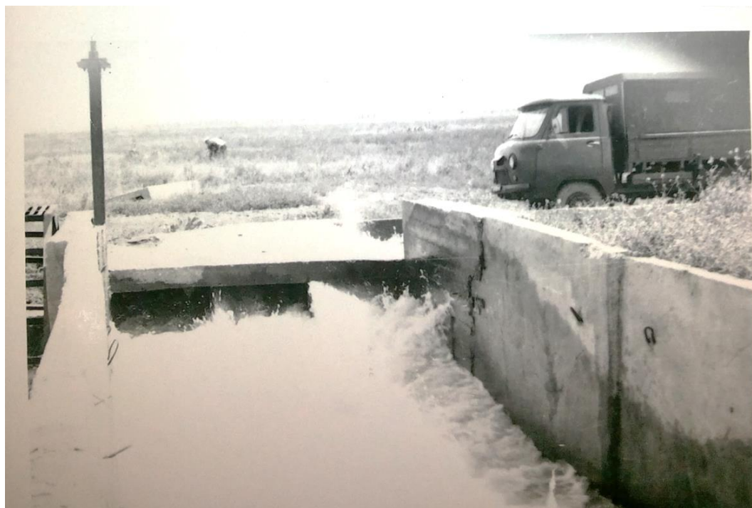
Рис.6.15. Поворотное сооружение на канале «Новый» с.р.Шамси. а – вид сбоку – до реконструкции; б – вид с нижнего бьефа – после рекон- струкции (с двумя разделительными стенками).
