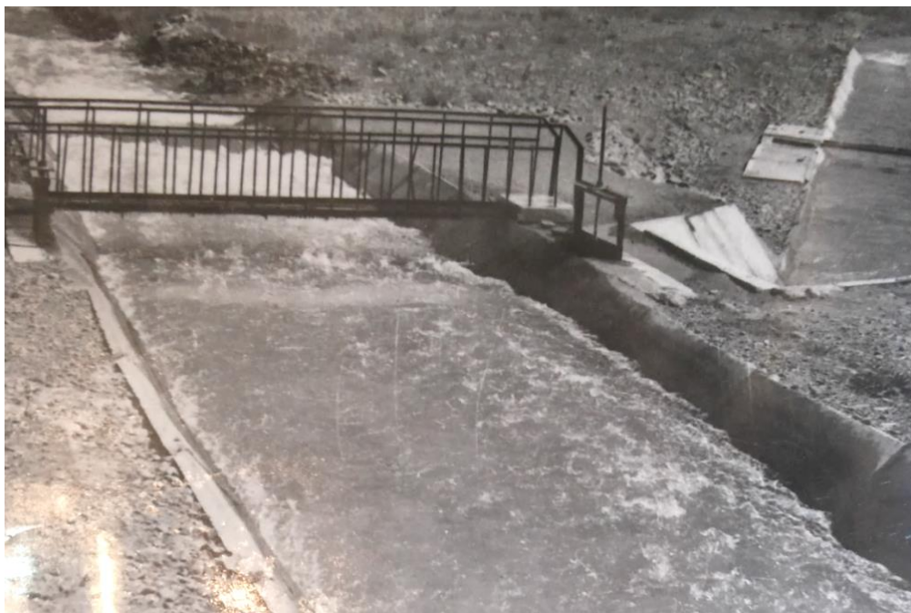
Рис.8.13. Водораспределитель – стабилизатор расхода воды (с квадратной водоприемной галереей) на канале Дён с.р.Кегеты.
