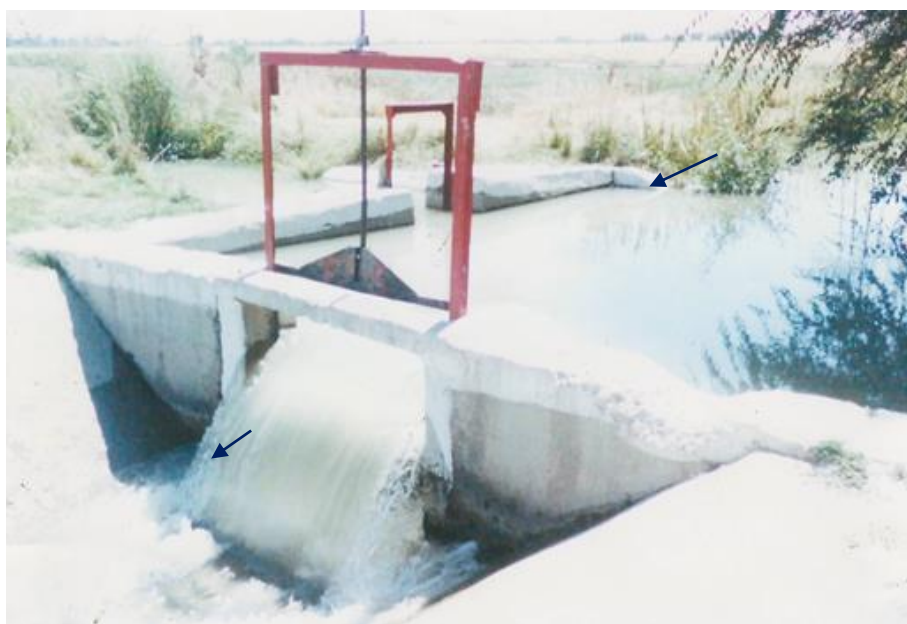
Рис.9.51. Водомерное сооружение на Р-7-13 прямо системы АМК.
